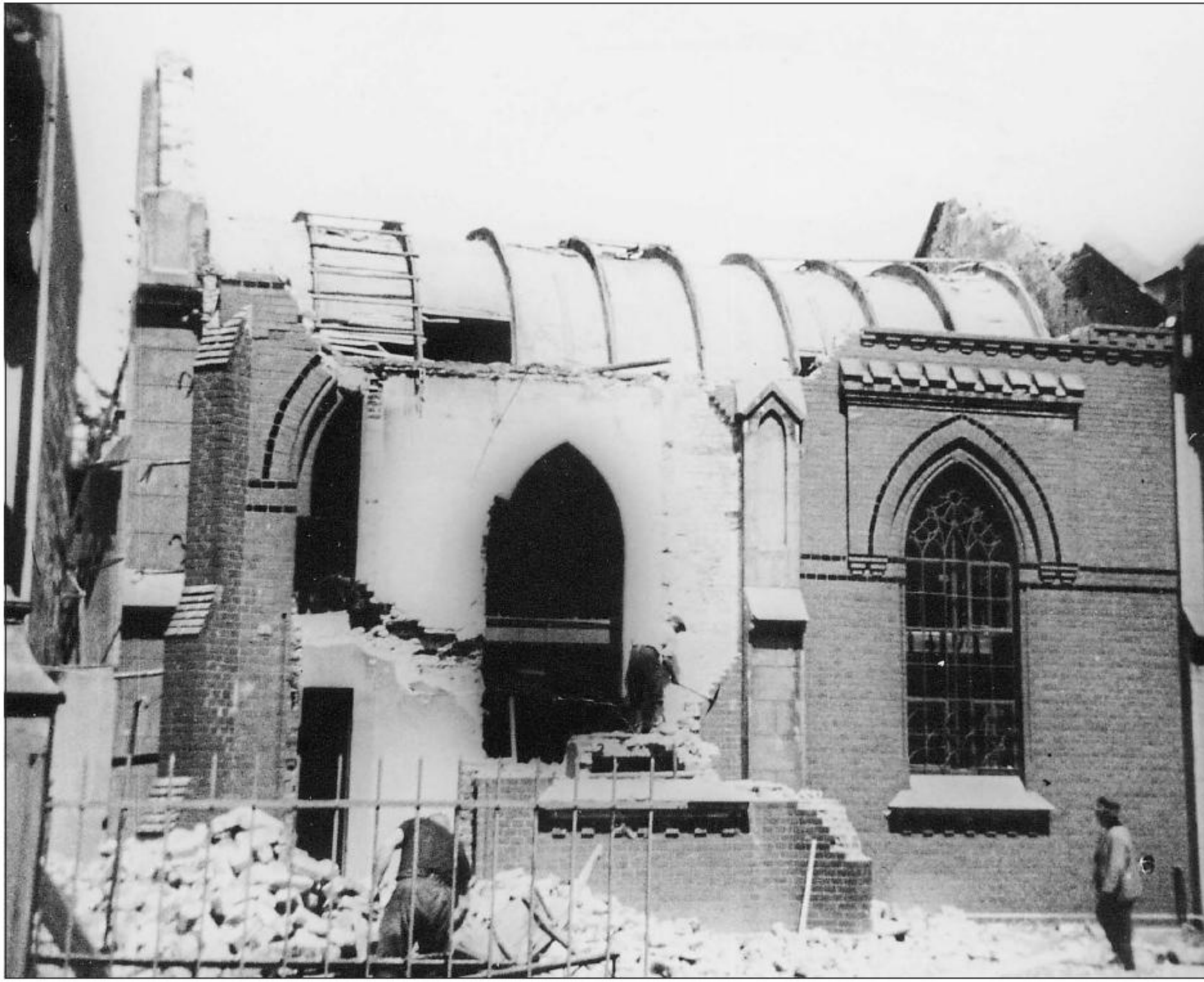
Diese Aufnahme entstand im Frühjahr 1939: Nachdem sich kein Käufer für die Synagoge fand, wurde die Gemeinde seitens der Stadt angehalten, selbst für einen Abriss zu sorgen. Anschließend musste sie das Grundstück verkaufen. Foto: Kommunalarchiv/Sammlung Heese
